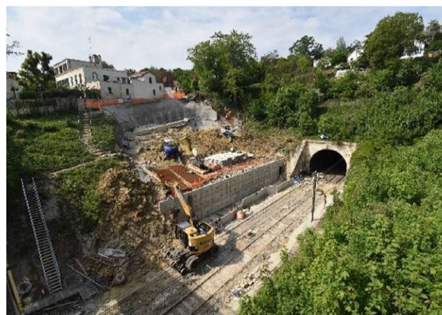
Depuis trois mois, la circulation des trains était interrompue suite à un éboulement de talus.
